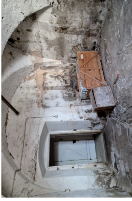
Das leerstehende und sehr sanierungsbedürftige Gebäude Marktplatz 31, Baudenkmal, 19. Jh. im Kern 17./18. Jh. plant der Eigentümer zu revitalisieren. © transform
